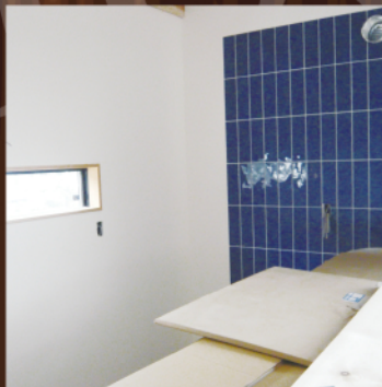
木のキッチンにタイル張りの壁
